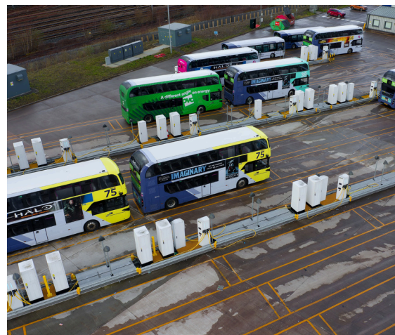
LEFT: Electric buses charging at Zajezdnia autobusowa Wola Duchacka in Krakow Poland.
